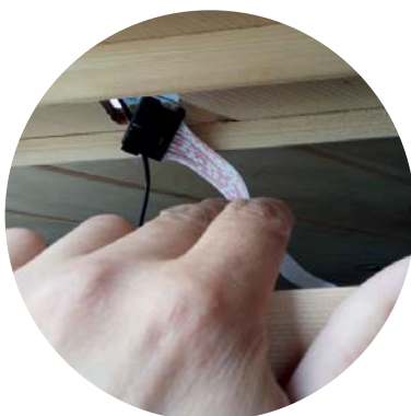
Ukázka propojení kabelů
