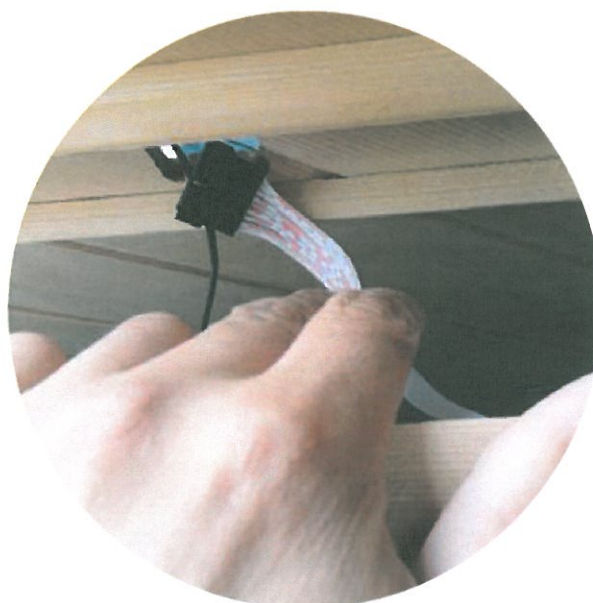
Ukázka protažení kabelů
