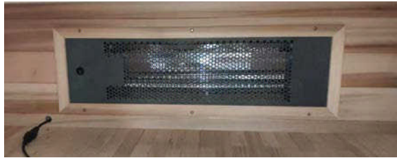
Prepojený kábel podlahového ohrievača
