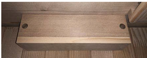
Zakrytý spoj kabelů
