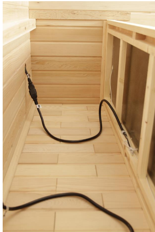
Foto č. 9 – kabely topidla propojená s kabely v zadní stěně
